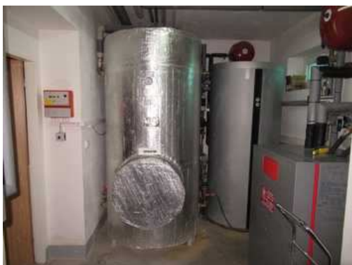
1.PP - tepelné čerpadlo
