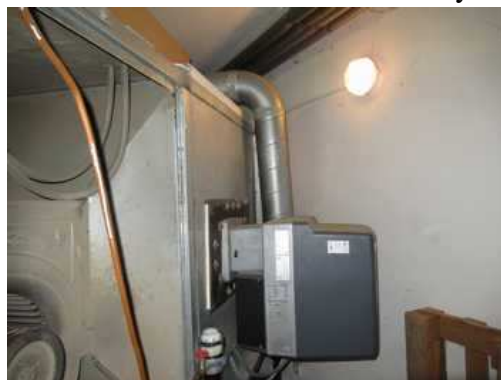
1.PP - strojovna vzuchotechniky
