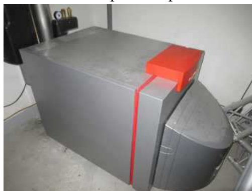
1.PP - kotel na LTO
